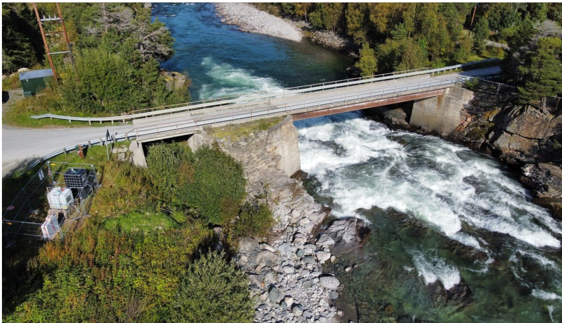
Figur 3. Doseringsstasjonen ved Skoremsbrua. Foto: Anders Gjørwad Hagen/NIVA
